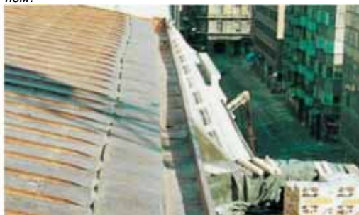
Разжелобки - включая водосточные колодцы - представляют наиболее важные детали крыши и подлежат точной проверке и техническому обслуживанию. Они должны быть очищены от снега зимой, и эту операцию очистки следует проводить осторожно, чтобы избежать повреждения кровли - пользуйтесь деревянной лопатой.
