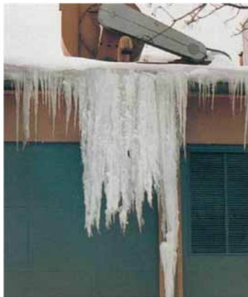
Ошибки, допущенные при проектировании или планировании. Сосульки указывают, что имеется недостаточная изоляция и/или дефектная вентиляция.
