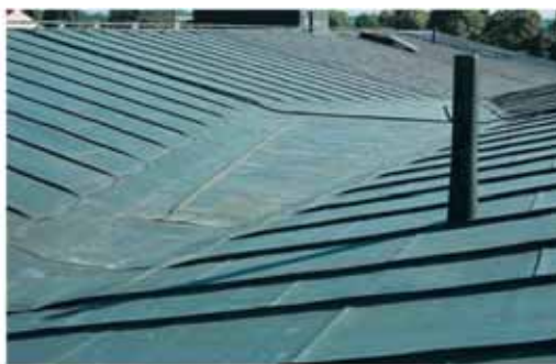
Правильно ли закреплен разжелобок? Имеются ли какие-либо трещины или любые другие повреждения в нем?
