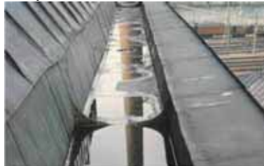
Забитые мусором водосточные колодцы могут стать причиной повышенных внутренних напряжений в кровельных материалах.
