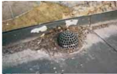
Водосточный желоб, в котором мусор, листья, и т.п. накопились у водосточного колодца.
