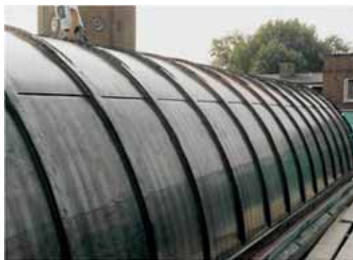
Боковые стороны листового металла, загнутые вверх и сращены друг с другом с применением металлической накладки.
